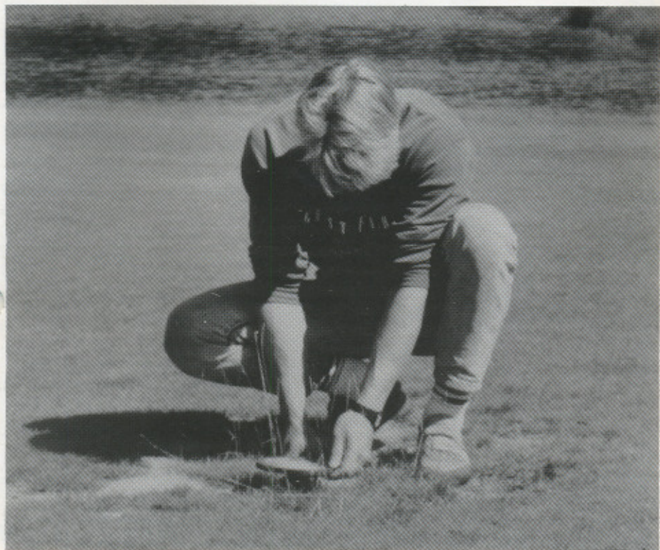
Matti Alhosalo näkee, että sadettajien suurin vihollinen hiekka on tukkinut väylän 15 yhden sadettajan. Puhdistustyötä riittää.
